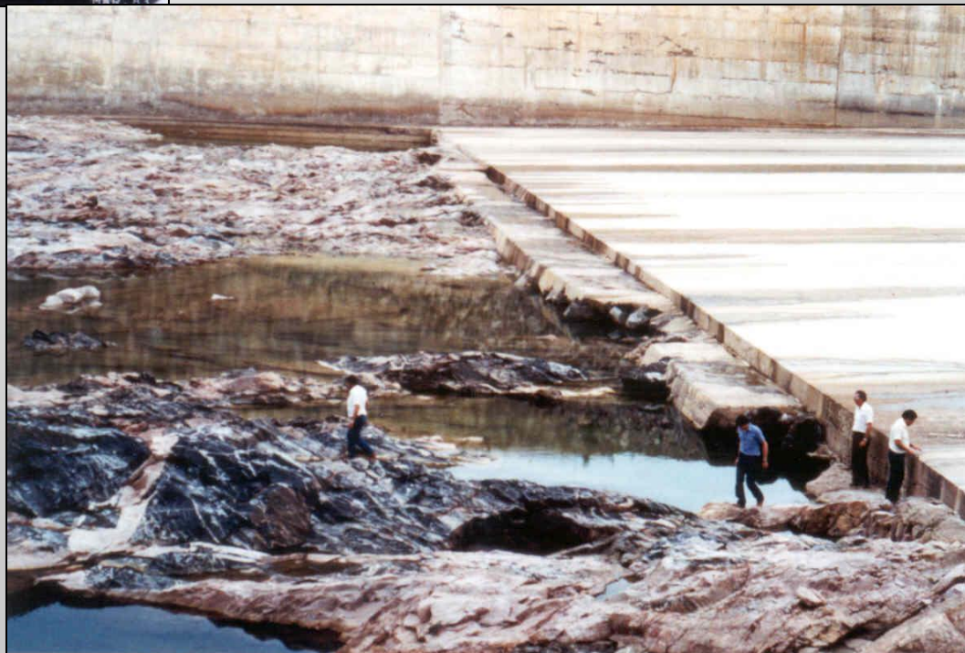
Erosão à jusante do vertedor
