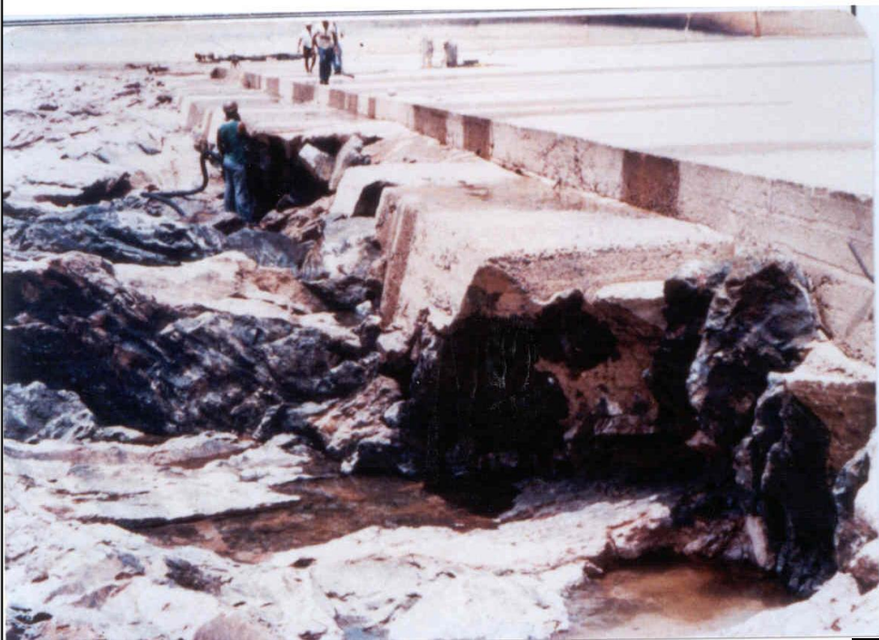
Erosão à jusante do vertedor
