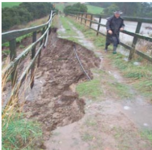
Figura 9 – Erosão do maciço de jusante e do coroamento após galgamento da barragem Fonte: SMEC, 2005 / Banco de Imagens ANA
