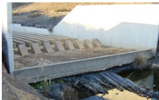
Figura 26 – Erosão a jusante da bacia de restituição do vertedouro Fonte: Banco de Imagens ANA
