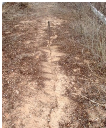
Figura 15 – Trinca longitudinal no coroamento Fonte: Banco de Imagens ANA
