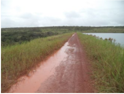
Figura 19 – Acumulação da água das chuvas no coroamento
