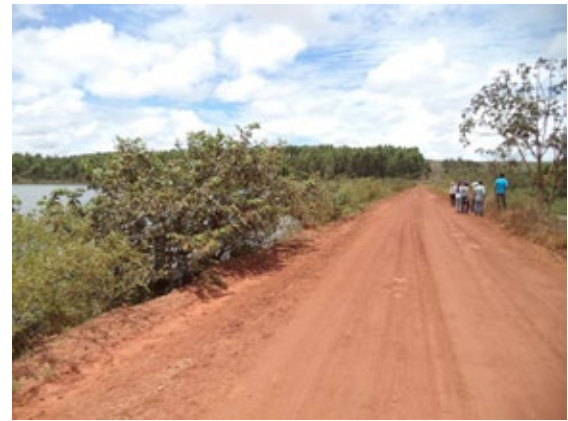
Figura 20 – Vegetação de tamanho excessivo no paramento de montante e de jusante
