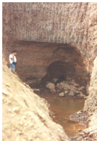
Figura 13 – Surgência em torno do conduto da descarga de fundo Fonte: Banco de Imagens ANA
