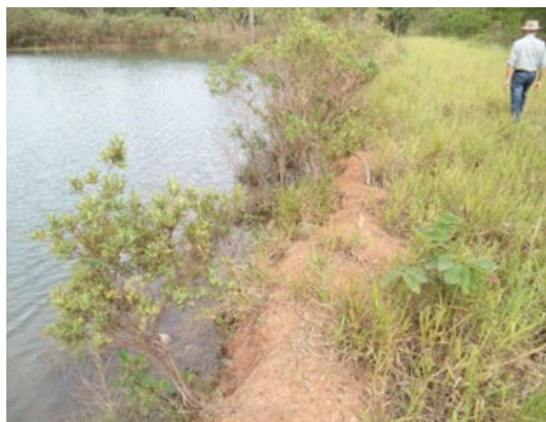
Figura 10 – Borda livre insuficiente Fonte: Banco de Imagens ANA
