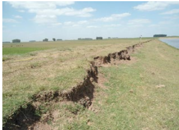
Figura 18 – Erosão do paramento montante sob a ação das ondas
