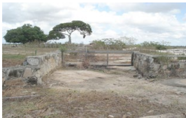
Figura 25 – Obstrução da soleira do vertedouro Fonte: Banco de Imagens ANA
