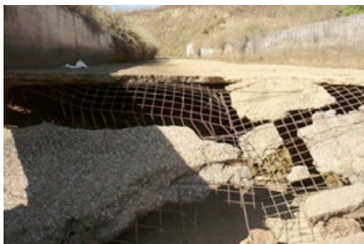
Figura 24 – Danos estruturais severos na soleira do vertedouro Fonte: Banco de Imagens ANA
