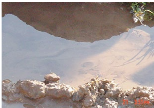
Figura 12 – Erosão regressiva com a deposição de um cone de solo fino Fonte: Banco de Imagens ANA
