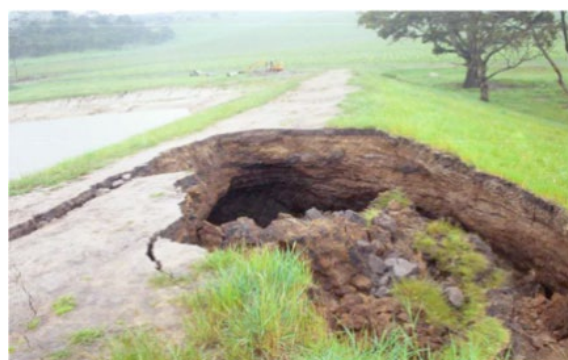
Figura 17 – Abatimento no coroamento e no paramento de jusante (SMEC, 2005)
