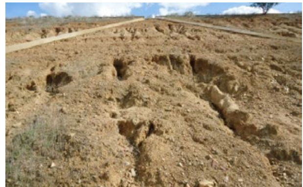
Figura 21 – Intenso ravinamento no paramento de jusante
