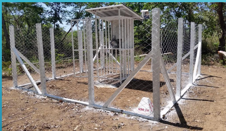
Estação Hidro Montante
