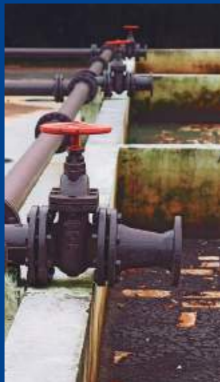
Tratamento de esgoto da Sanepar em Foz do Iguaçu
