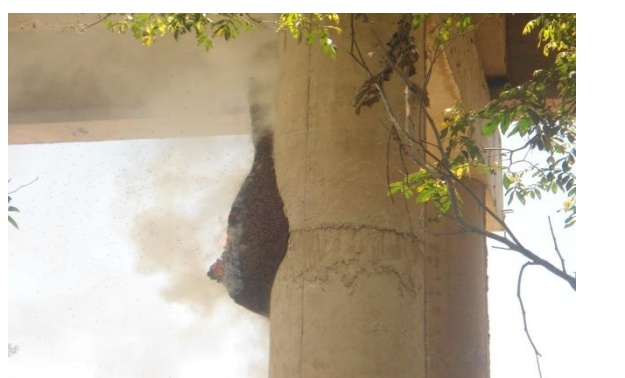
Fig. 27 - Vespeiro pegando fogo.
