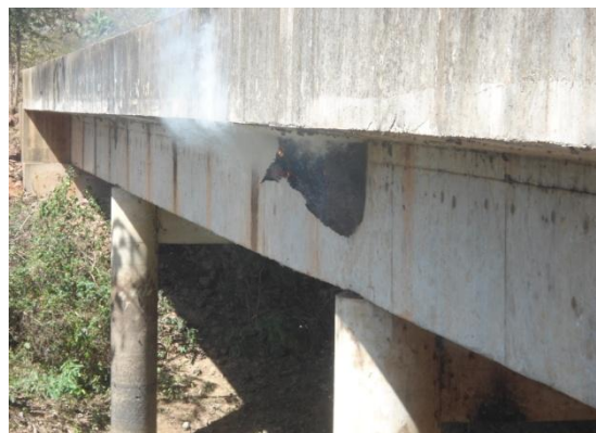
Fig. 49 - Vespeiro pegando fogo.
