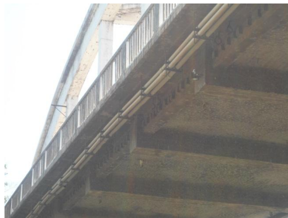
Fig. 62 – Fiação instalada em baixo da ponte aproveitando a encanação existente.
