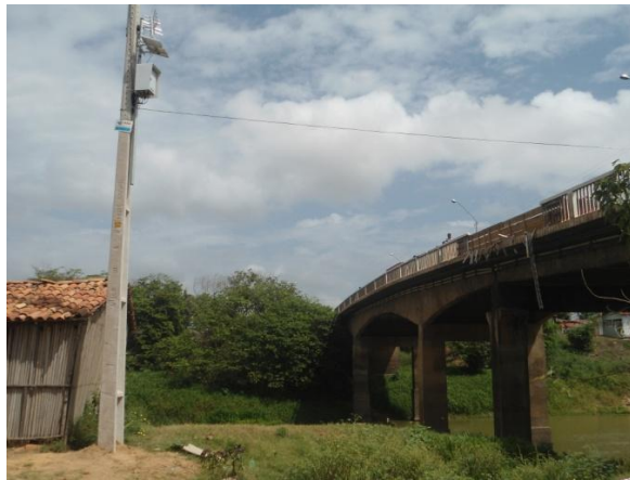
Fig 32 - Vista do cabo aéreo ligando a PCD a ponte
