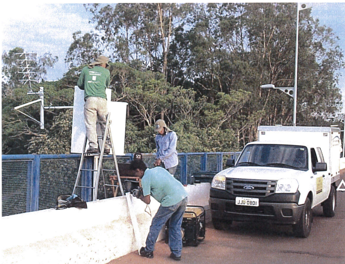
Figura 5 – Instalação da estação fluviométrica de Palmeiras – Rio Aquidauana.
