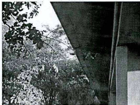
Figura 12 – Instalação do sensor ultrassônico, PCD Fazenda Angicos.
