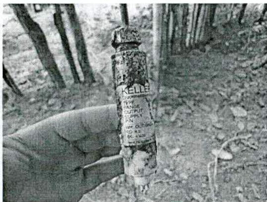
Figura 1 – Sensor de Pressão danificado, PCD Gov. Dix-Sept Rosado.
