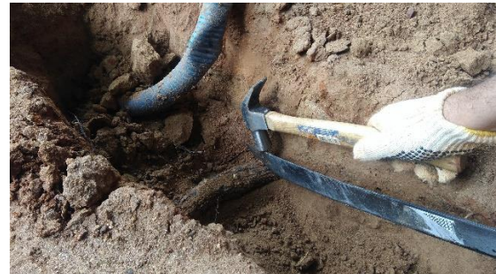
Foto 4.4 - Mangote amassado devido ao crescimento de raízes.
