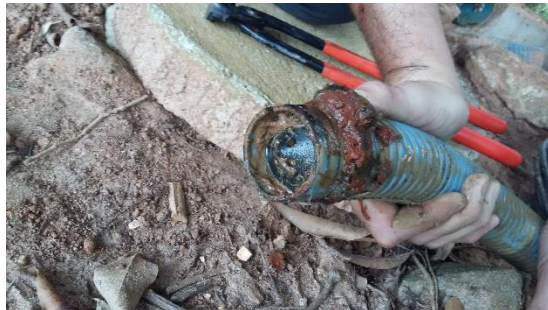
Foto 4.3 – Ponta do mangote com sonda sem funcionamento. Abraçadeira de metal enferrujada.
