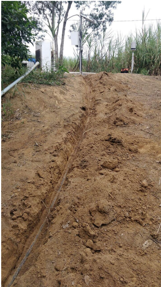
Foto 4.5 - Retirada do mangote de proteção do cabo do transdutor de pressão danificado.
