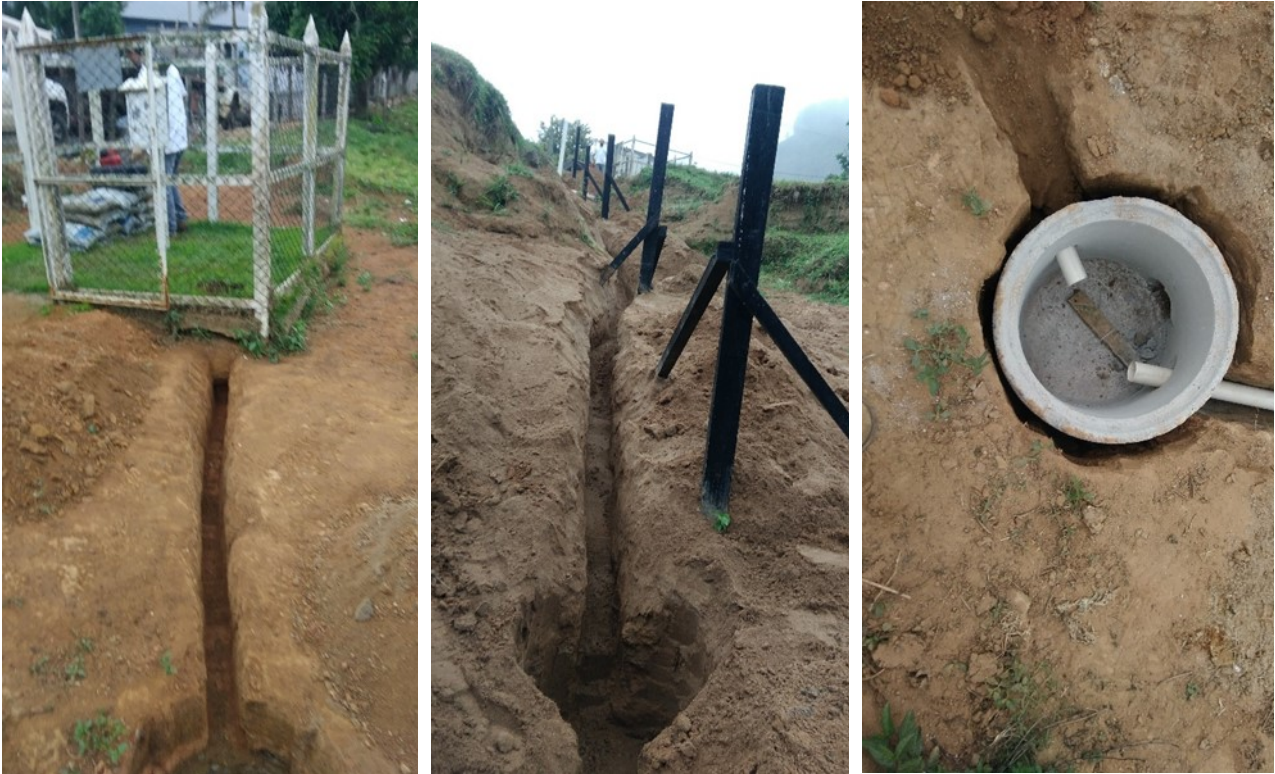
Foto 4.1 - Fotos da instalação da PCD e transdutor de pressão na estação de Ibitirama.
