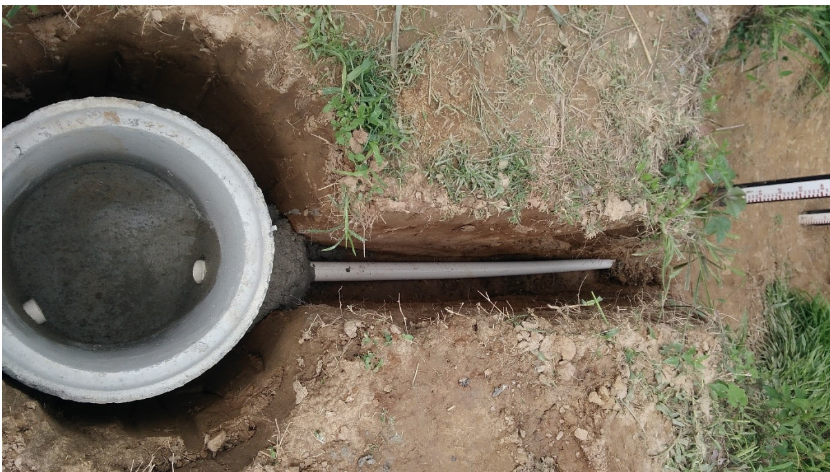
Foto 4.4 – Caixa de passagem para manutenção do transdutor de pressão.
