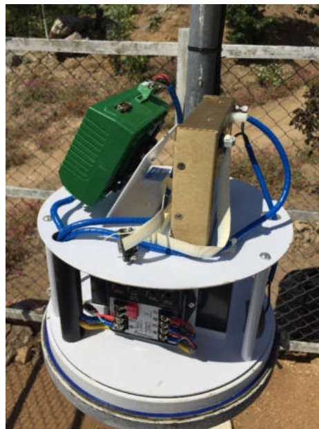
Figura 7 - Cabo modem GOES desconectado do datalogger – Quebrangulo - Fevereiro/2019
