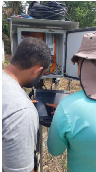
Figura 3 - Substituição modem GOES – Cajueiro – Dezembro/2019
