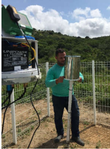
Figura 2 - Substituição do Pluviômetro – Brejão – Setembro/2019
