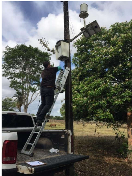
Figura 03 - Manutenção datalogger – Fazenda São Pedro – Dezembro/2020
