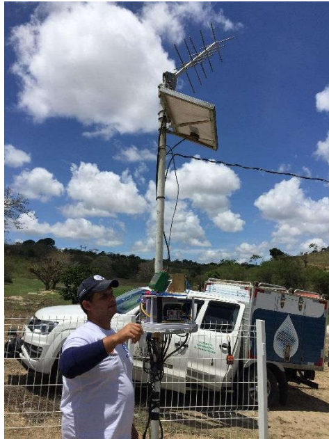
Figura 01 - Substituição da bateria – Brejão – Fevereiro/2020
