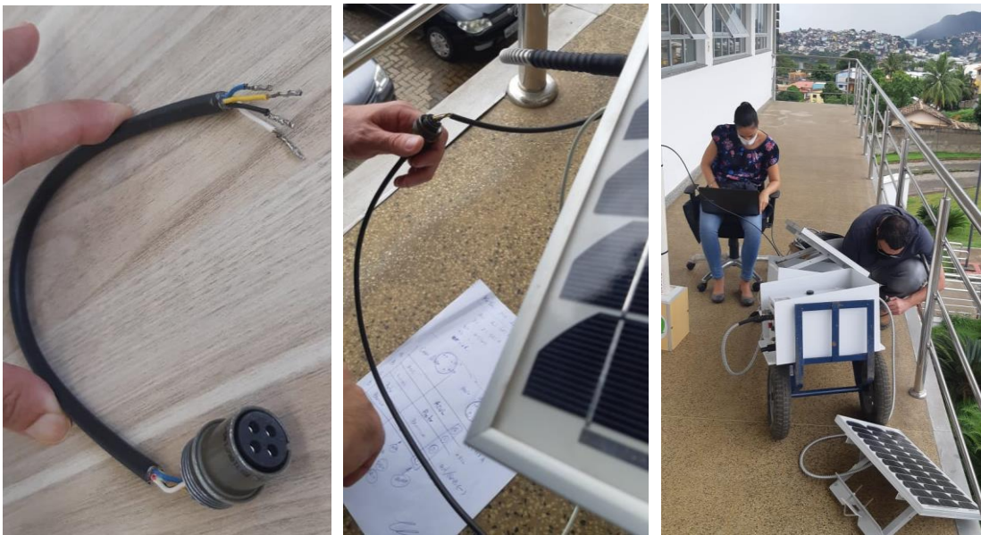
Foto 01 - Cabo auxiliar de teste e esquema elétrico utilizados para identificar a alteração no transdutor modelo 36x, 2012 que foi utilizado nas PCDs da Rede de Alerta.
