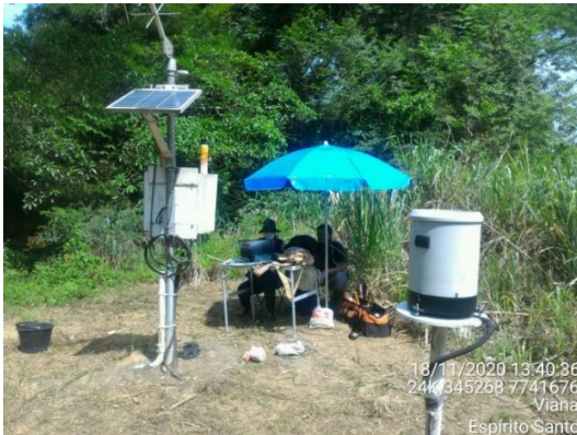
Foto 02 – Configuração da PCD para instalação do transdutor de pressão no dia 18/11/2020.
