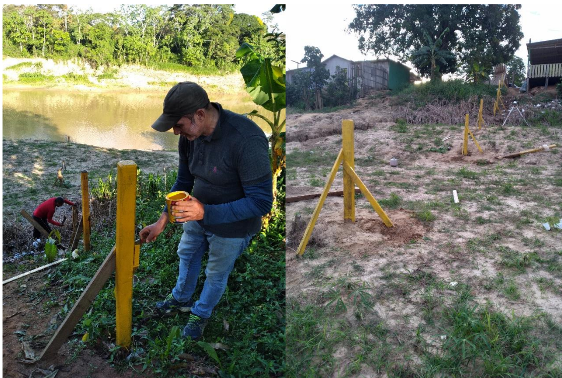
Foto 4: Manutenção corretiva da Plataforma de Coleta de Dados e reconstrução do posto de régua, Município de Porto Acre - Acre.
