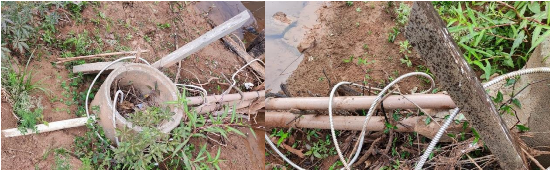
Figura 4.3 - Estação Ibitirama – sensor de pressão vandalizado
