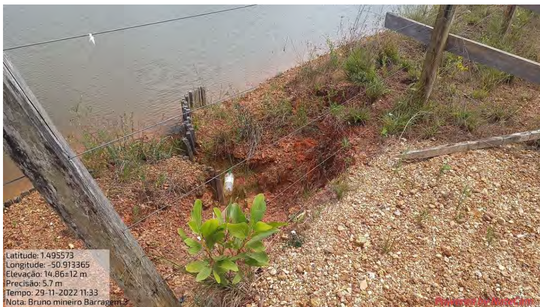
Fotografia 15: Erosão no talude à jusante da Barragem 3.
