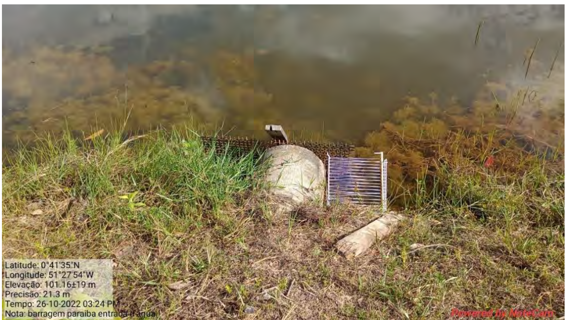
Fotografia 62: Estado do dreno da barragem Paraíba.
