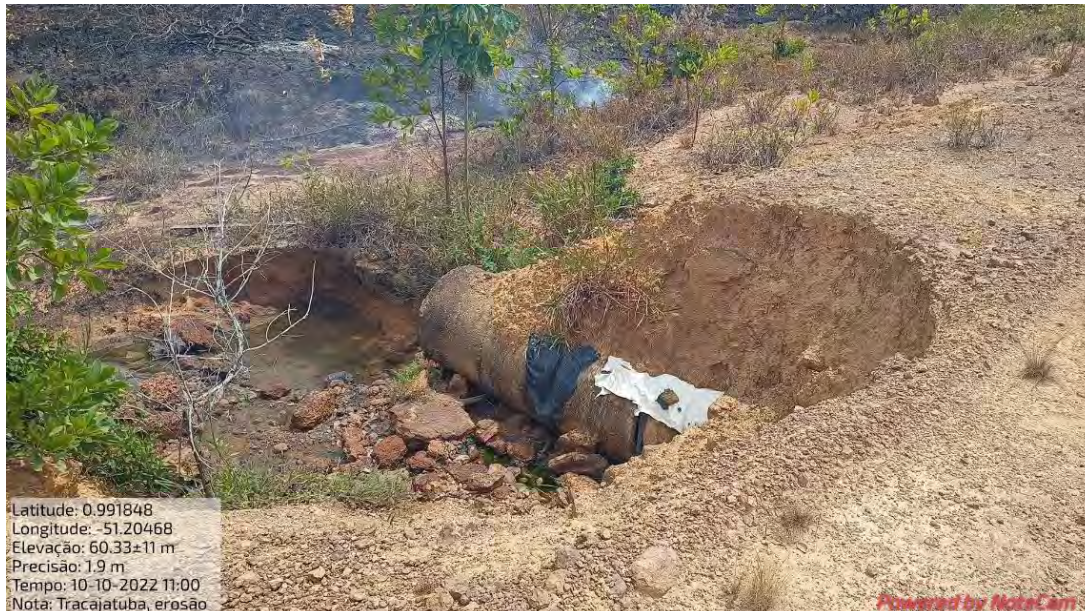
Fotografia 6: Erosão próxima ao vertedouro.
