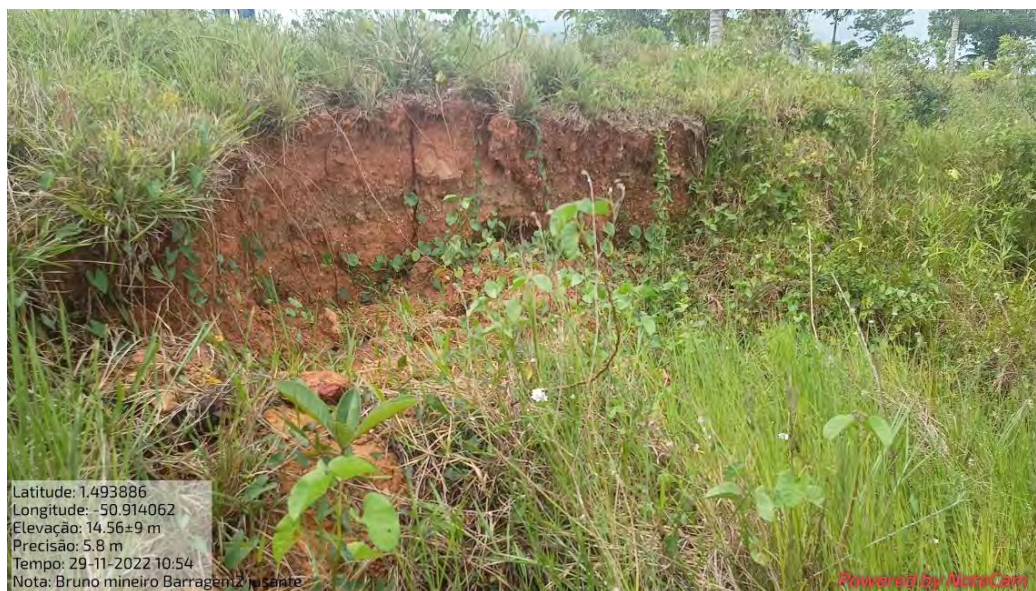
Fotografia 14: Erosão no talude à jusante da Barragem 2.
