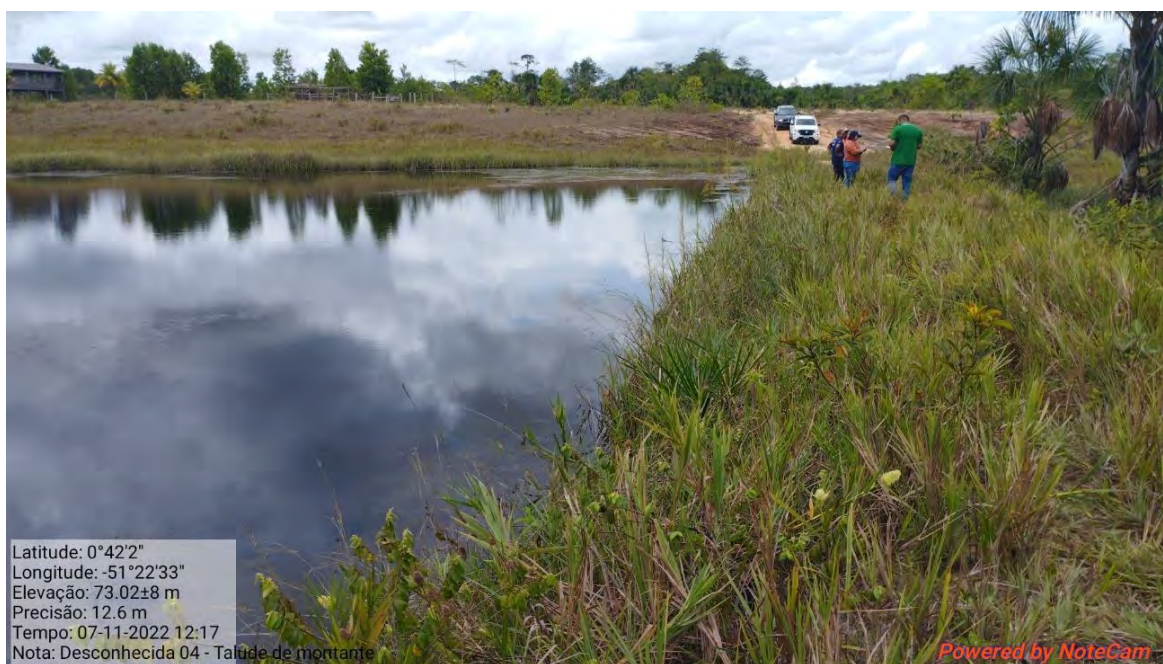
Fotografia 72: Presença de vegetação nos taludes jusante e montante.
