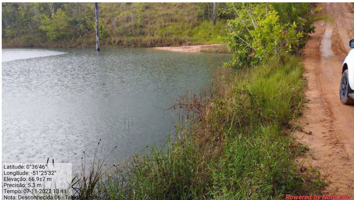
Fotografia 74 - Presença de vegetação no talude montante.
