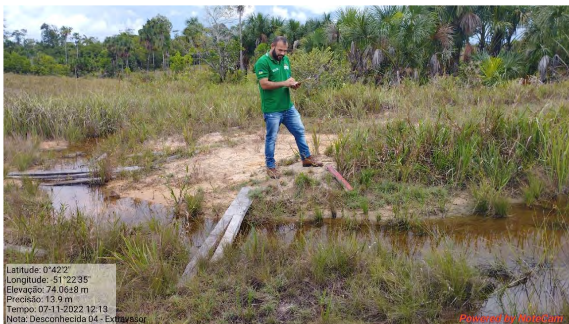
Fotografia 73: Presença de vegetação no vertedouro.
