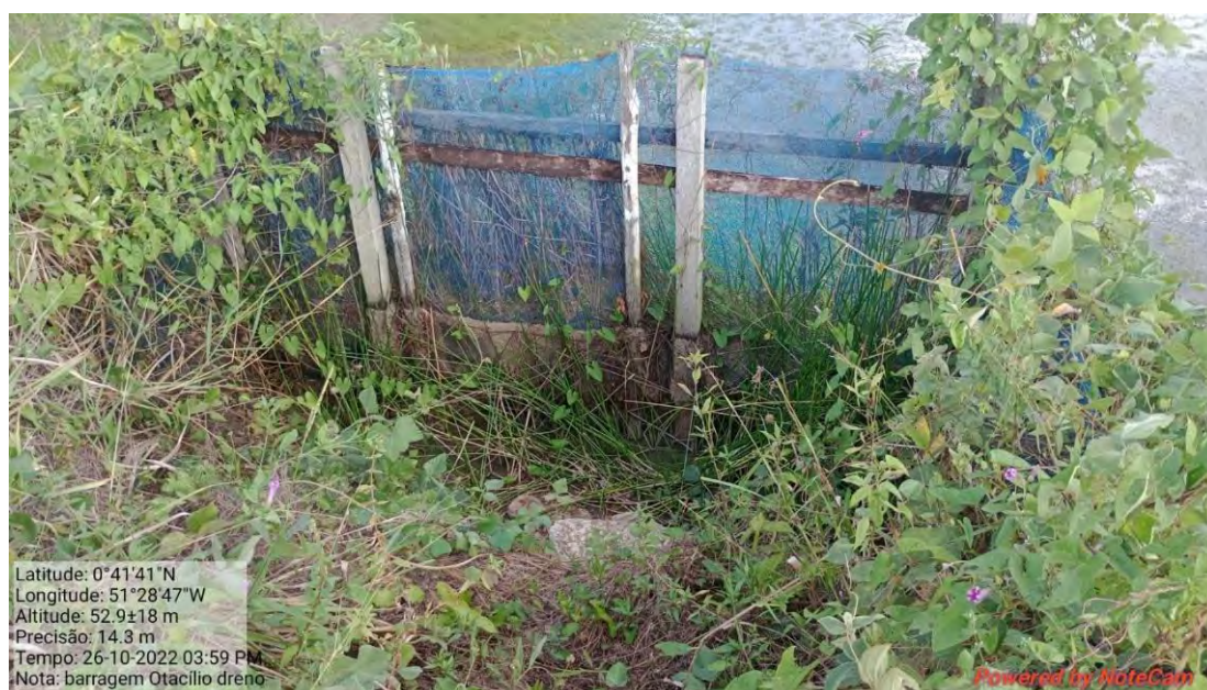
Fotografia 57: Dreno da barragem Nova Esperança.
