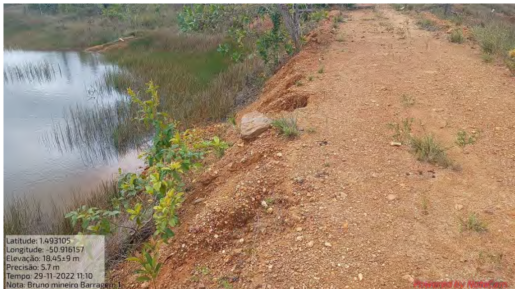
Fotografia 13: Erosão no talude à jusante da Barragem 1.
