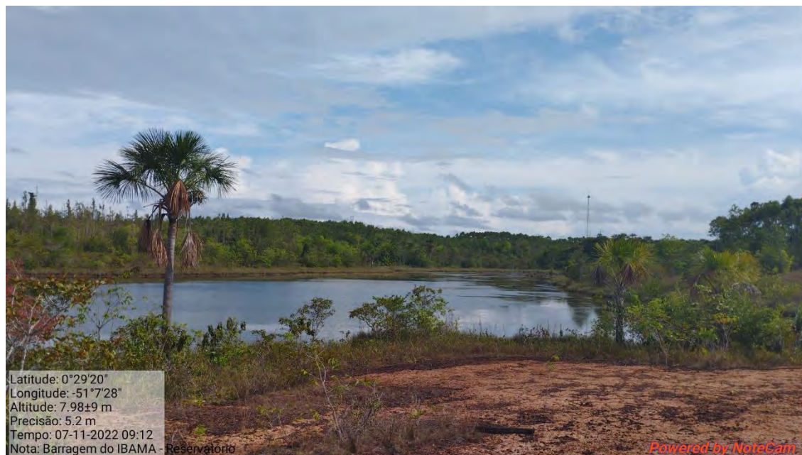
Fotografia 66: Presença de vegetação nos taludes jusante.
