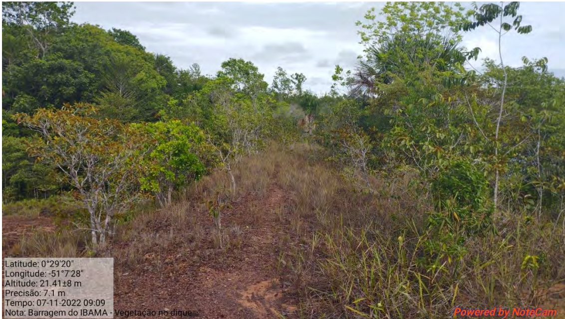
Fotografia 67 - Presença de vegetação nos taludes jusante
