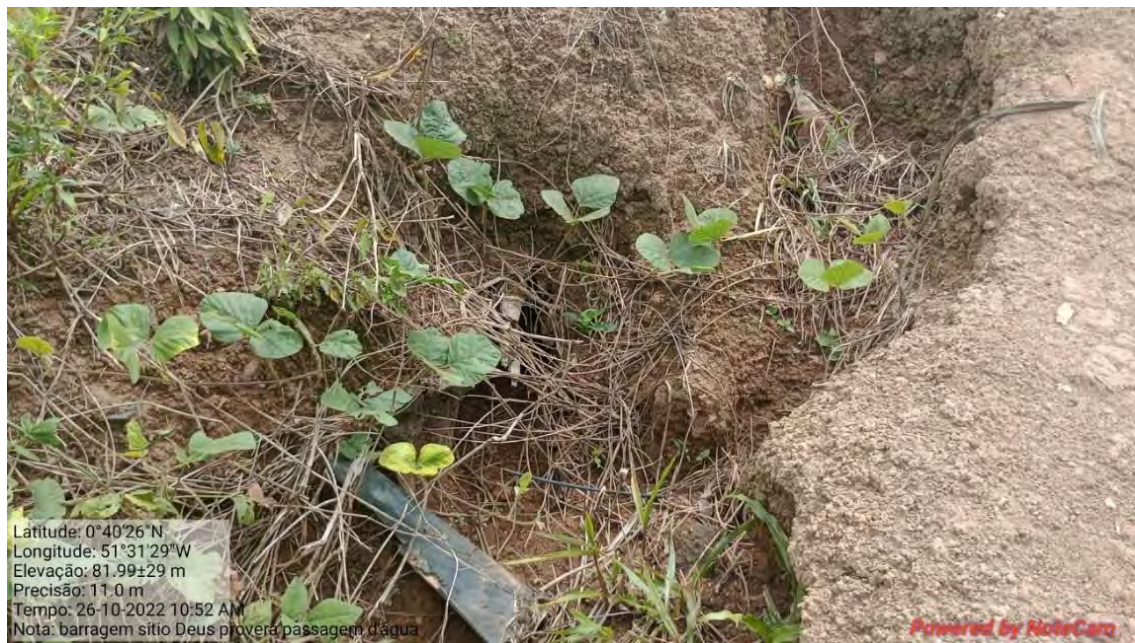
Fotografia 50: Canaleta da barragem Deus Proverá, parcialmente encoberta.
