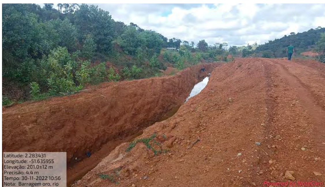
Fotografia 25: Canal construído pela empresa Oro Amapá Mineração para escoar o excesso de água da Barragem Oro.
