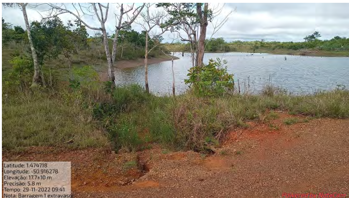
Fotografia 28: Erosão na ombreira direita.
