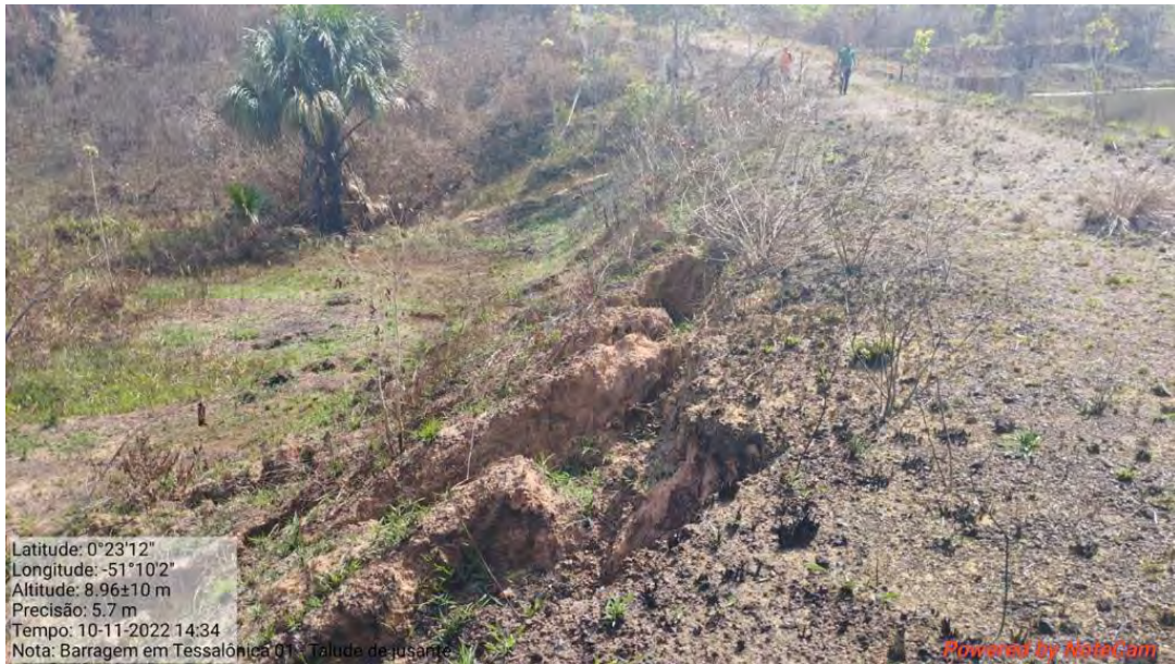
Fotografia 81: Talude jusante com erosões.
