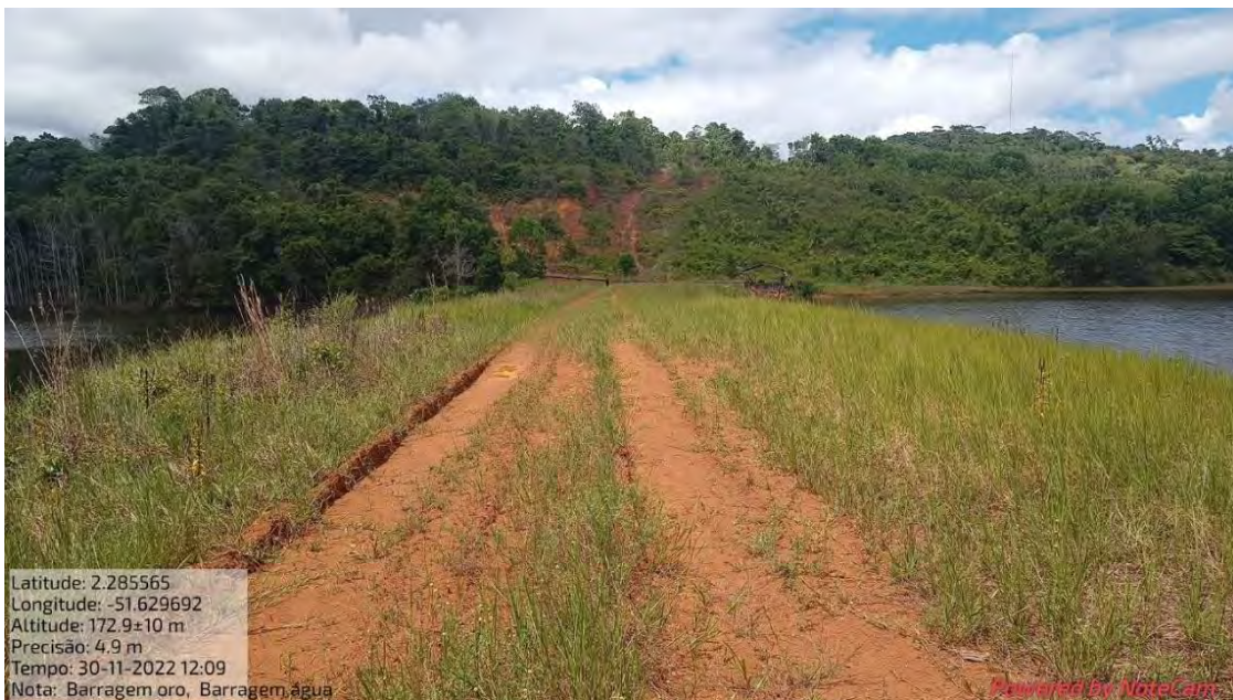
Fotografia 21: Erosão e vegetação na crista da barragem.
