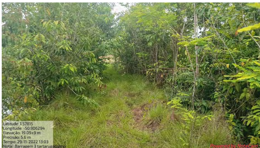
Fotografia 18: Presença de árvores e arbustos na crista e taludes da barragem.
