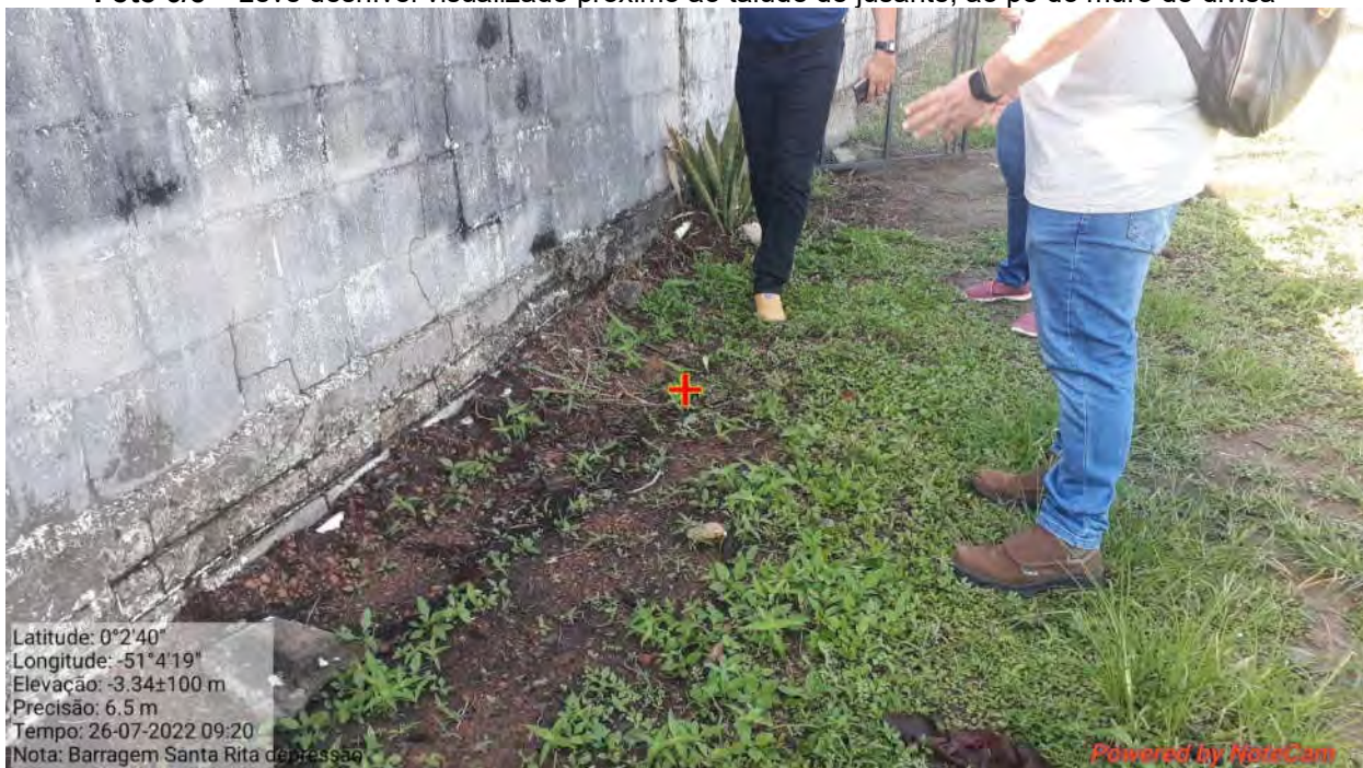
Foto 6/8 – Leve desnível visualizado próximo ao talude de jusante, ao pé do muro de divisa
