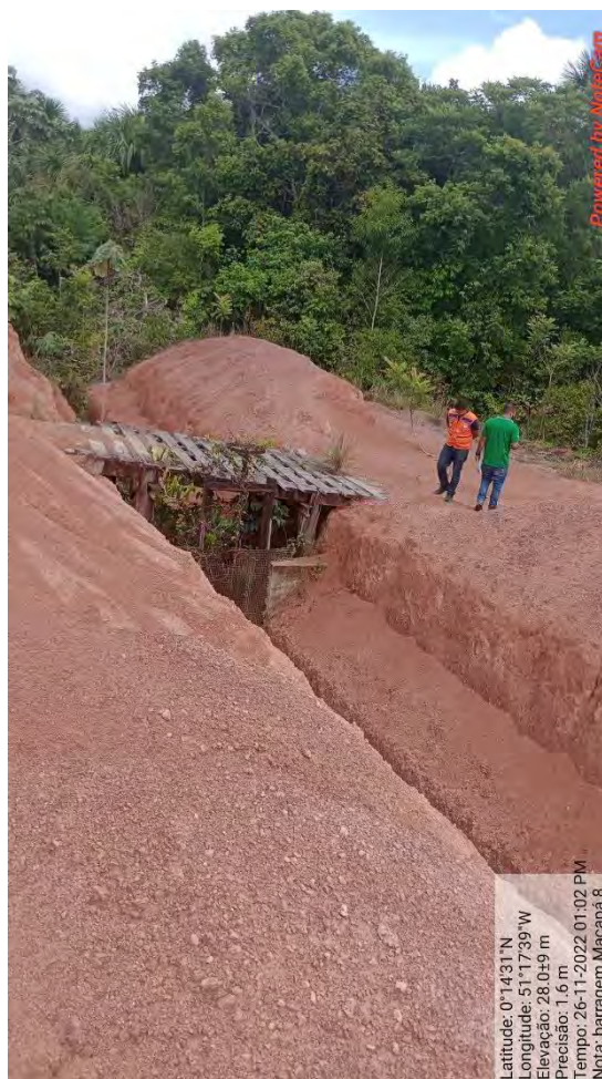
Fotografia 92: Vertedouro, sem proteção, ausência de sinalização.
