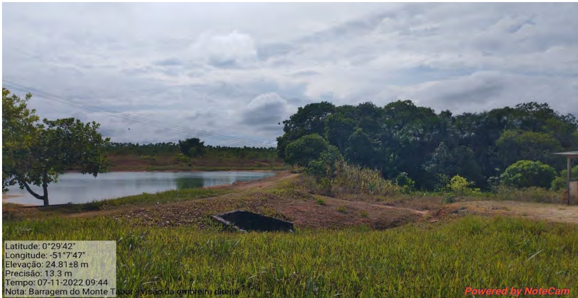
Fotografia 68 - Presença de vegetação na crista da barragem.
