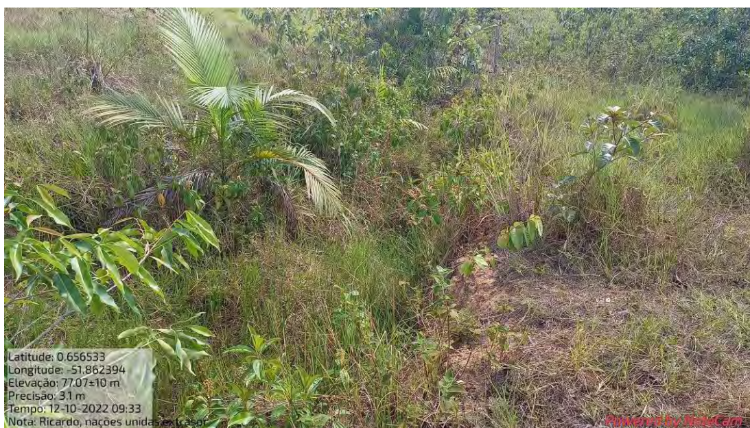
Fotografia 30: Vertedouro obstruído por vegetação.
