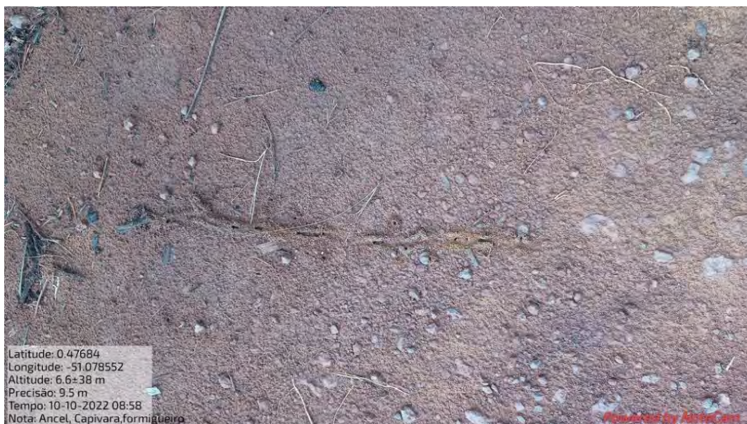
Fotografia 3: Formigueiro na crista.
