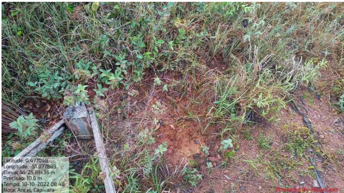
Fotografia 2: Infiltração próximo ao talude de jusante.
