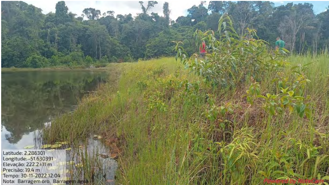
Fotografia 20: Presença de vegetação rasteira e arbustos no talude à montante.
