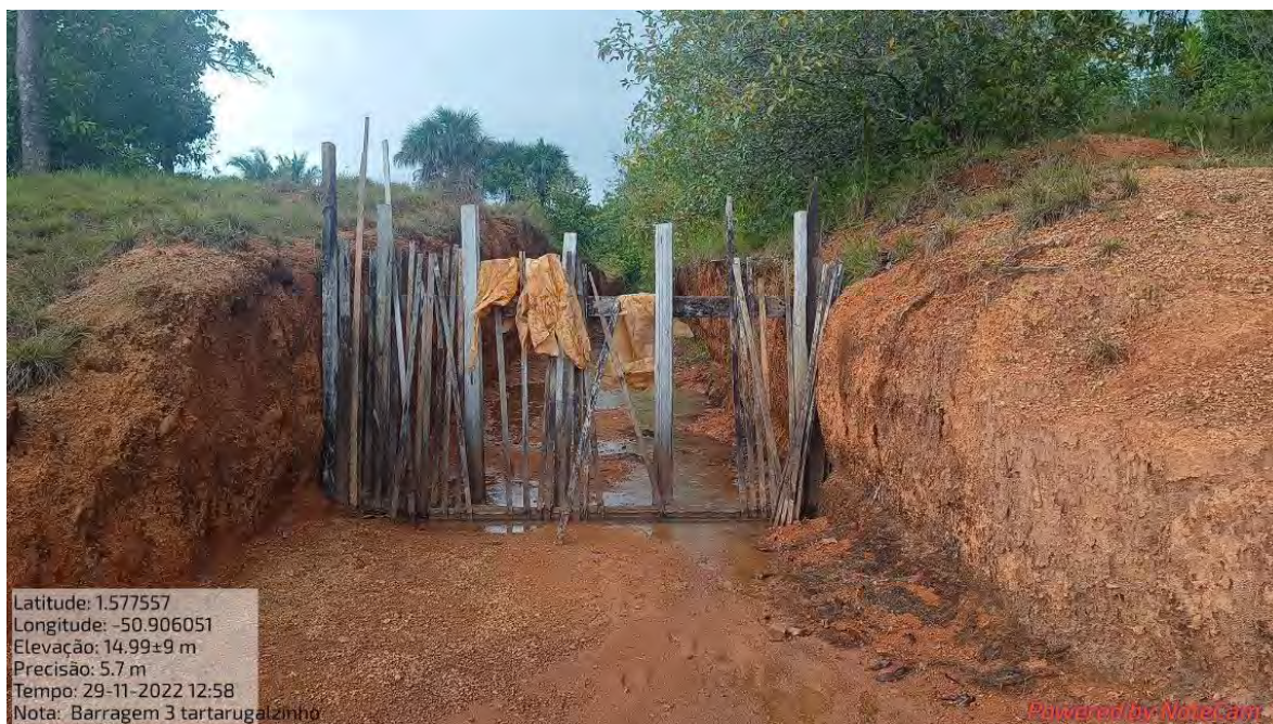
Fotografia 19: Vertedouro alargado sem padrões técnicos.
