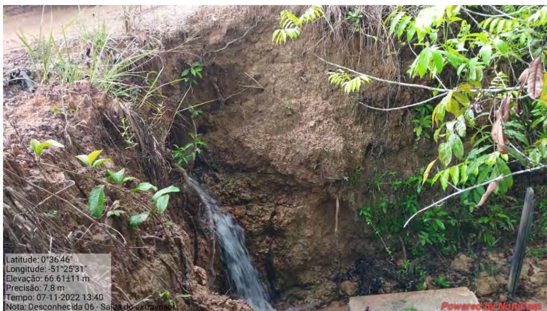
Fotografia 76: Extravasor em tubo de concreto apresenta erosões
