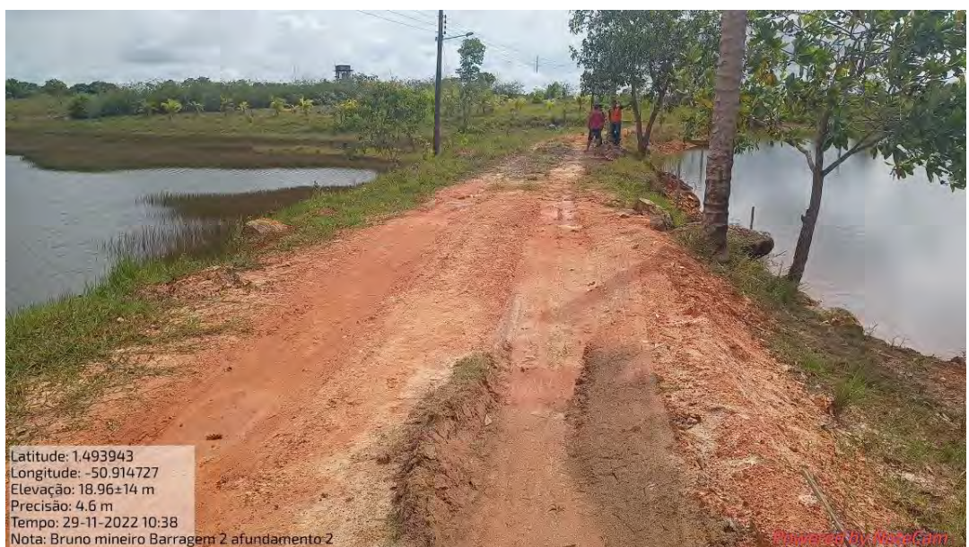
Fotografia 16: Presença de vegetação à montante da Barragem 2.
