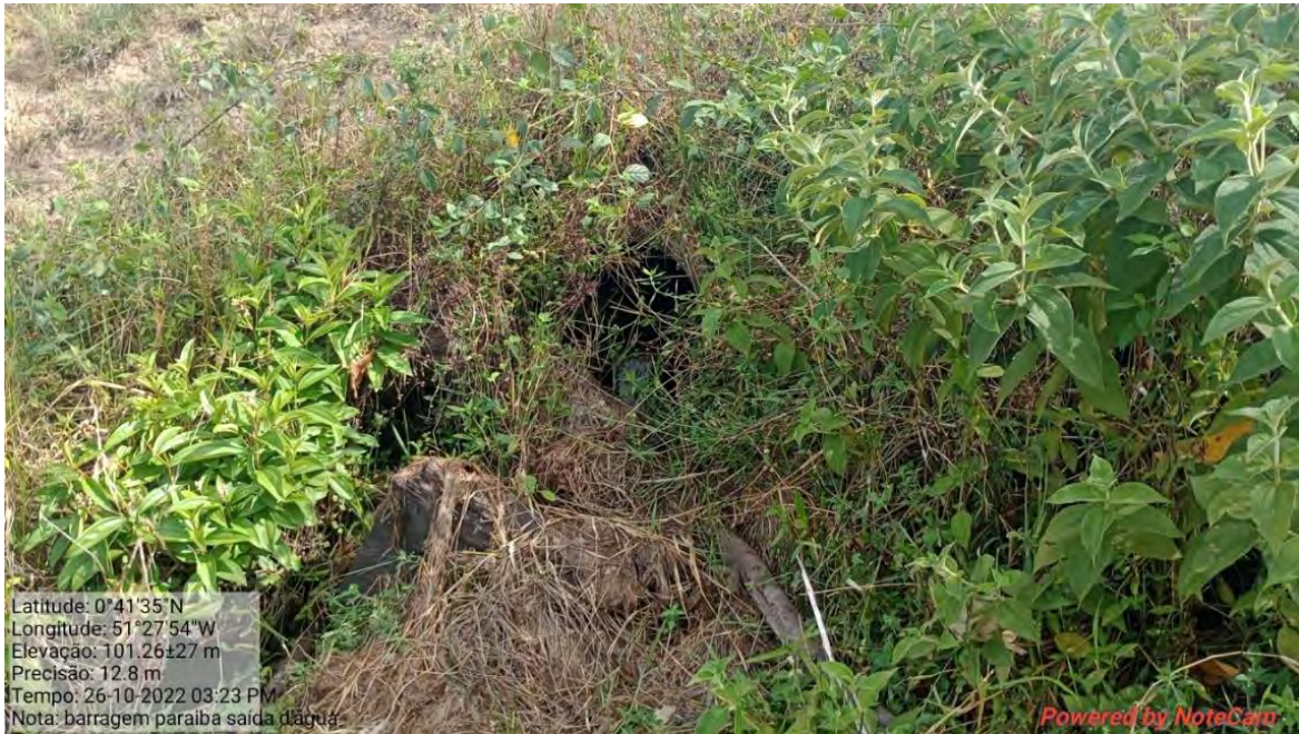
Fotografia 61: Saída do dreno da barragem Paraíba, parcialmente encoberto.
