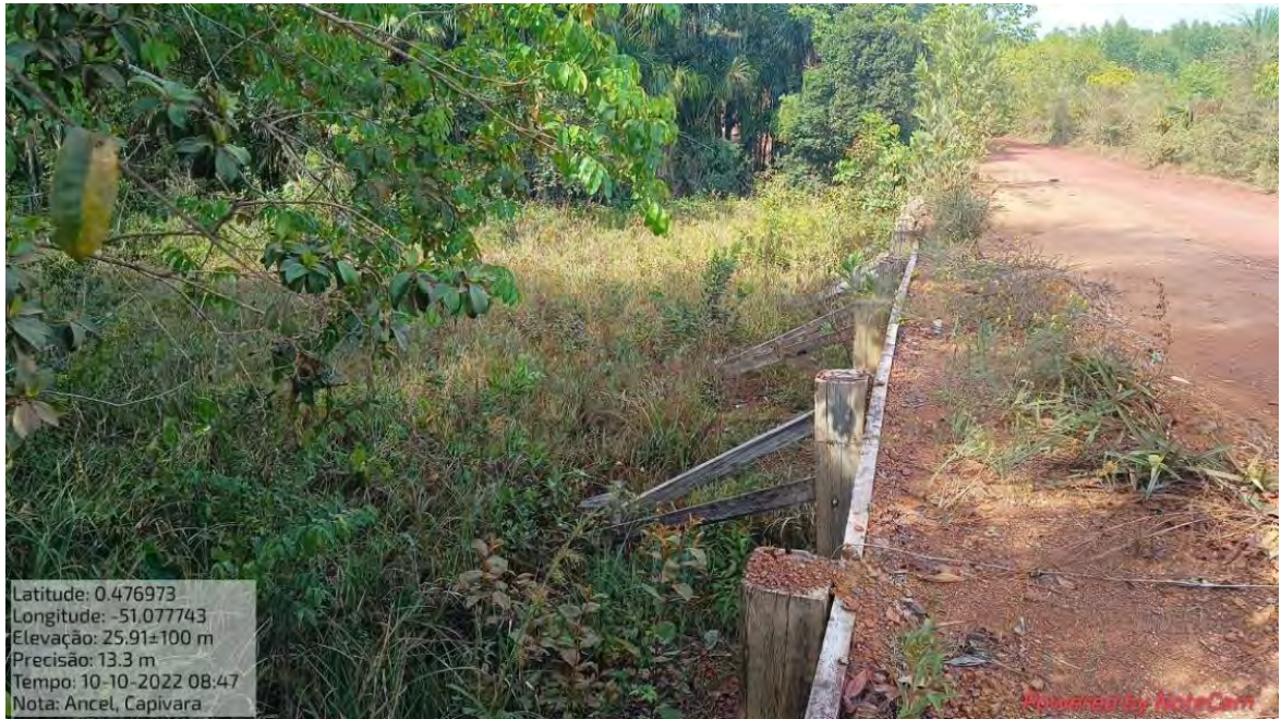
Fotografia 1: Uso de madeira para conter erosão no talude de jusante.
