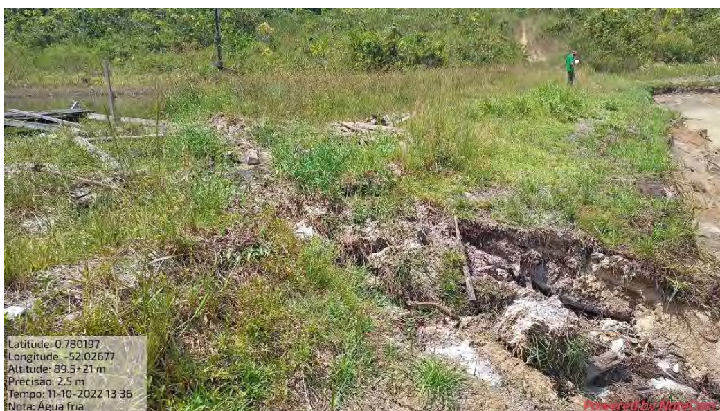
Fotografia 12: Presença de erosão na crista da barragem.
