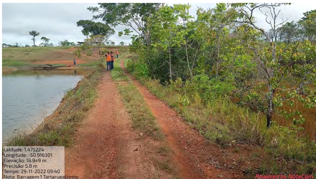
Fotografia 26: Presença de arbustos e árvores de médio porte na crista e nos taludes da barragem.
