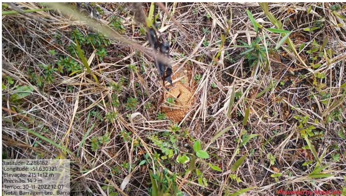
Fotografia 22: Formigueiros na crista da barragem.
