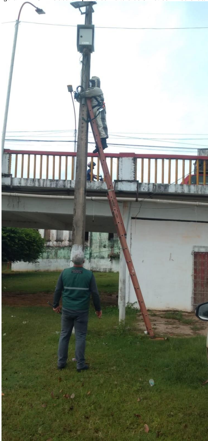
Figura 11 - PCD inslada em poste com altura de 6 metros – Pedreiras/MA
