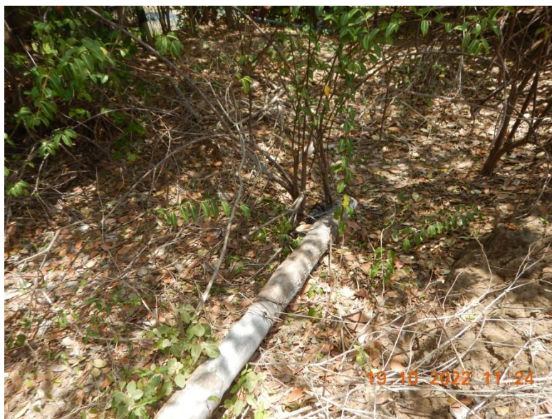
Figura 4 – Estrutura de suporte do cabeamento danificada
