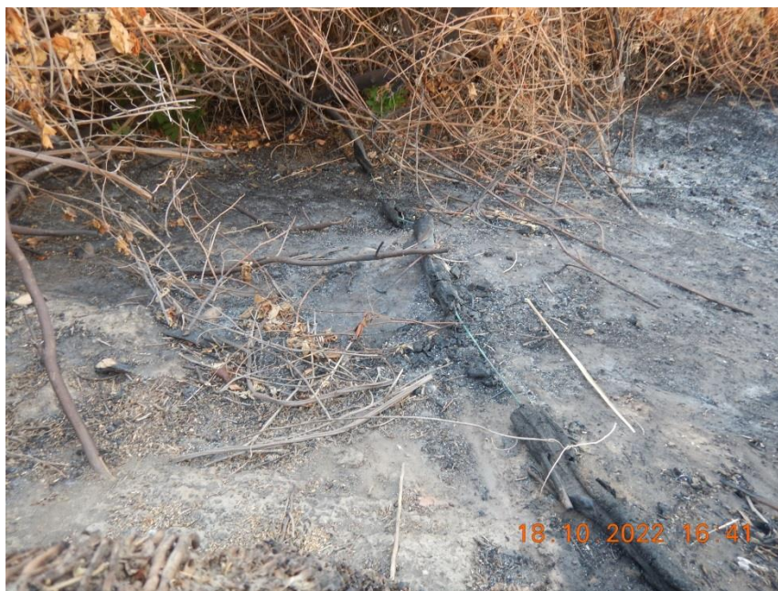
Figura 5 – Cabeamento danificado pelo fogo
