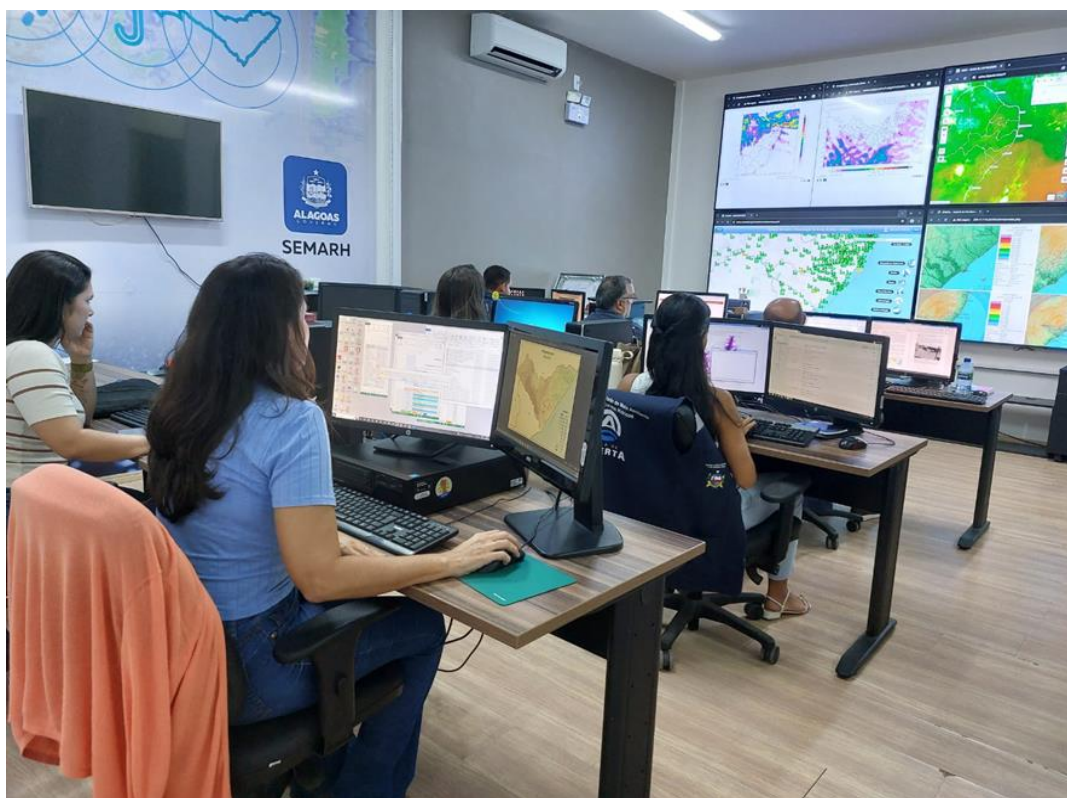
Figura 14 - Nova Sala de Alerta da Superintendência de Prevenção em Desastres Naturais da SEMARH.
