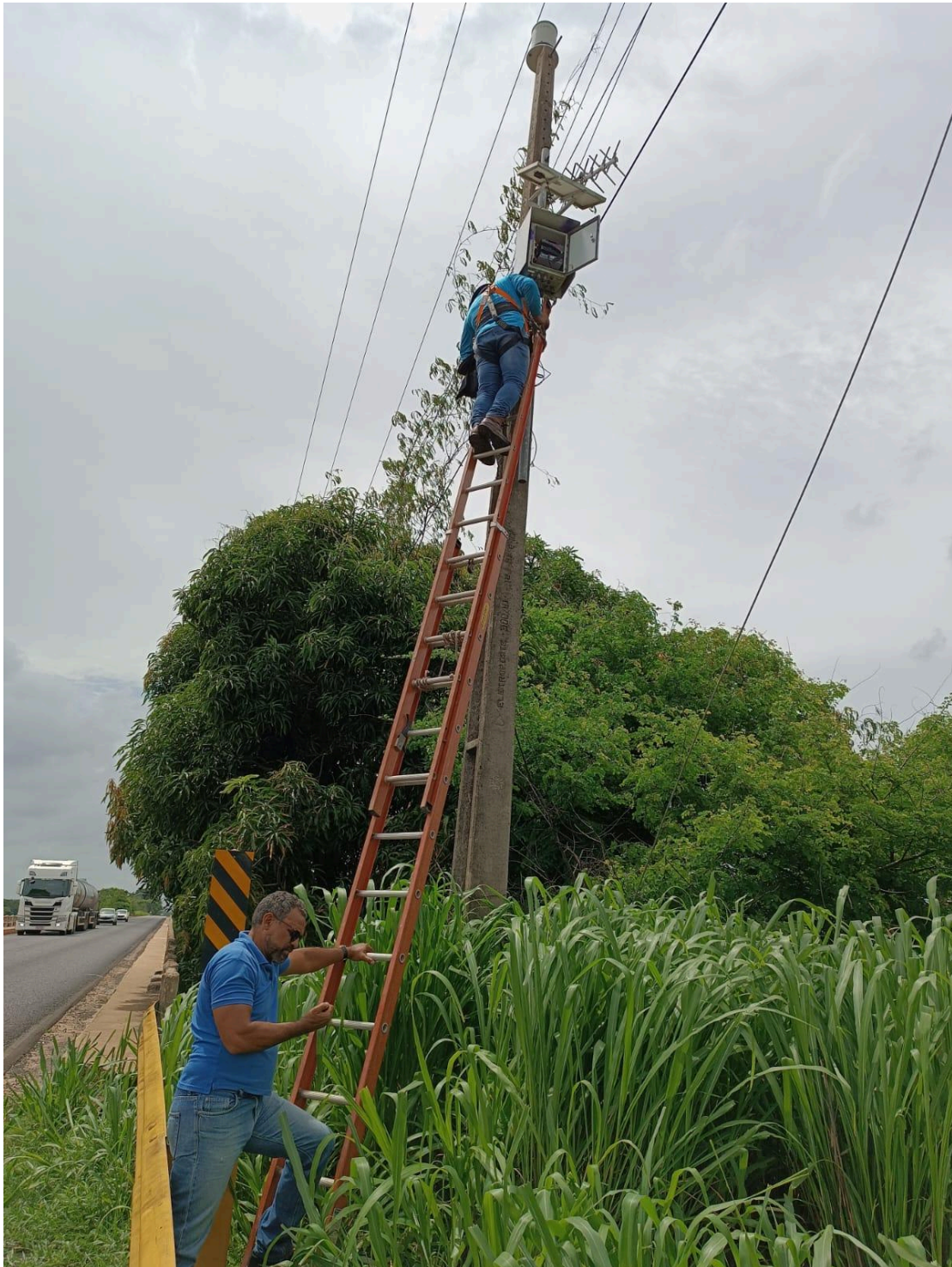
Imagem 20 - PCD instalada em poste com altura de 6 metros – Bela Vista/MA
