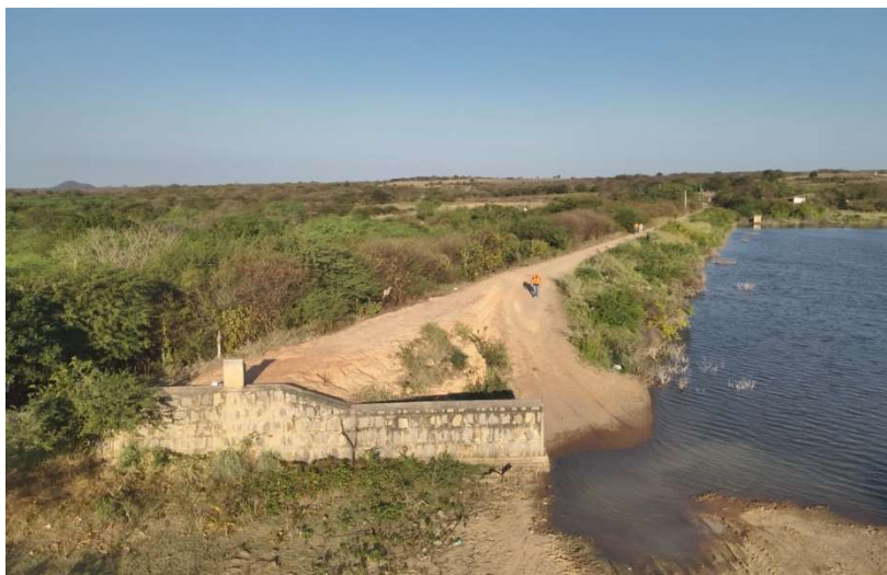
Figura 10 – Evento em Araripina – Barragem Barriguda – 2024.
